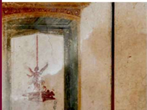
Intonaco dipinto con macchie di umidità (Casti Amanti; amb.13)
