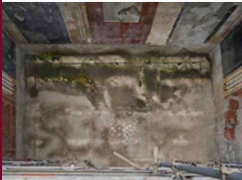
Pavimento con evidenti macchie da umidità (Civico 9 amb.U)
