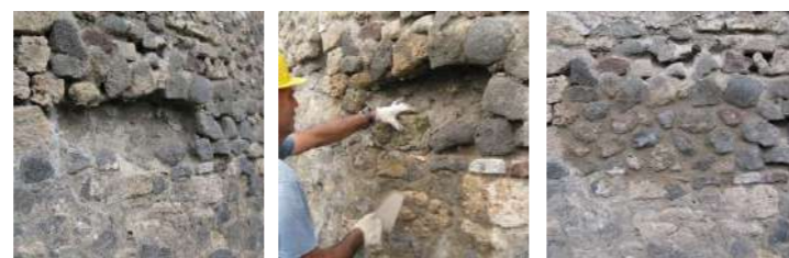
FASE 2 - EROSIONE E CEDIMENTO DEL PARAMENTO : RIPRISTINO MURARIO SUPERFICI
