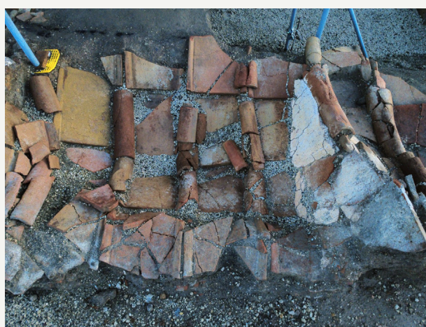
FIG. 19 Ambiente C, particolare del rattoppo della copertura. Da est.
