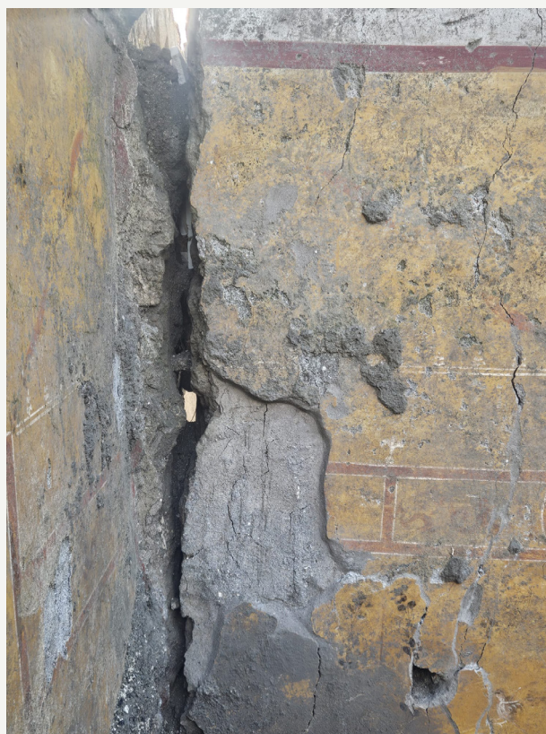
FIG. 16 Ambiente B, parete sud. Distaccamento e lesione del tramezzo sud. Da nord.
